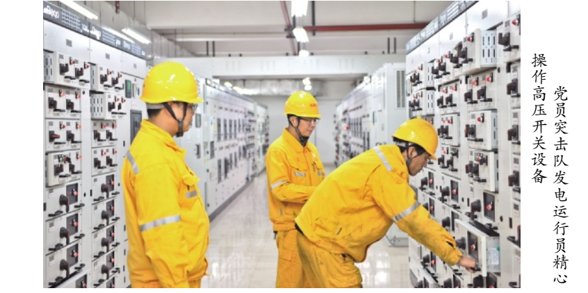
党员突击队发电运行员精心操作高压开关设备
